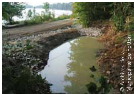
Bassin de rétention aménagé près des fossés du chemin de l'Étang Sugar-Loaf
